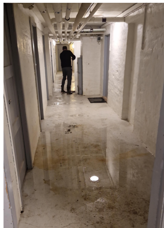
Blankt vand i kælderen efter regnvejr
