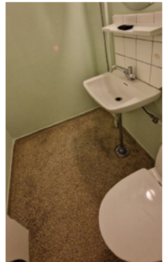
Badeværelserne er så små at brugsfunktionen er dårlig
