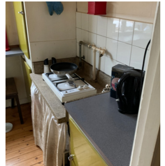
Mange køkkener er originale med gas. Gasinstallationen nedlægges
